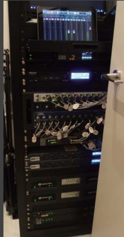
▲ バックヤードの機材ラック。「Ui24R」「BLU-160」「BLU-120」などが設置されている。iPadは「Ui24R」のコントロール用。
