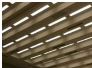
▲天井のサラネットの奥にJBL PROFESSIONALのControl 29AV-1が設置されている。
