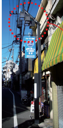
LED採用のECO街路灯 防犯カメラや放送用のスピーカーも併設。
