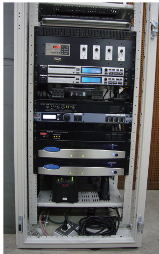
コントロールルームの機材たち
