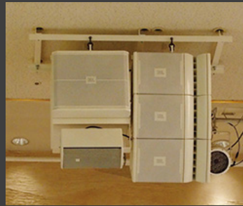
◀分割したときに使用する「VRX932LA-1」×3と「VRX918S」「AC18/95」のシステム。このシステムが3部屋全てに片側1セットずつ設置されている。「AC18/95」はアレイ直下に向けたフロント・フィル用。
