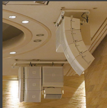
◀手前が連結したときに使用する「VRX932LA-1」×4と「VRX918S」のシステム。片側1セットずつ設置されている。
