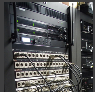
音響調整室のラック▶
